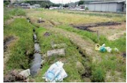
漏水が多く、用排兼用の水路
