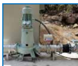
小水力発電所 (神戸市灘区)
