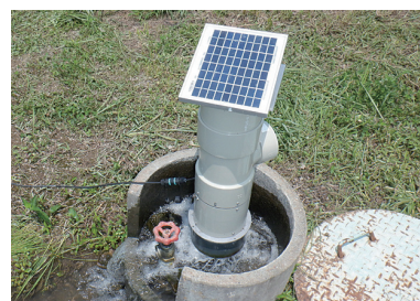
遠隔操作型自動給水栓（たつの市）
