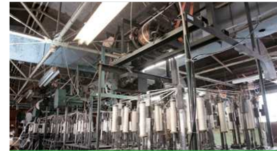
グランドパッキン現場
