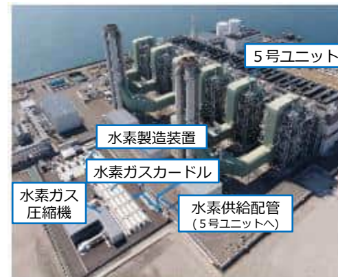
水素混焼発電実証設備 (関西電力姫路第二発電所)
