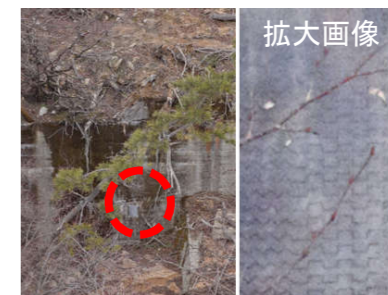
(8)治山ダムのクラック
