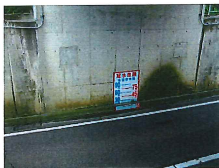
市道アンダーパス部の水位表示板
