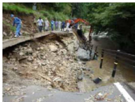
護岸崩壊による道路崩落箇所
