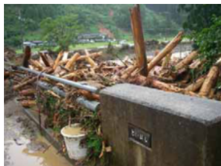
流木による橋梁箇所での閉塞状況
