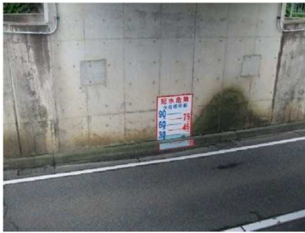
市道アンダーパス部の水位表示板
