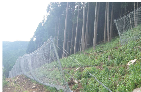
落石防護柵の事例写真
